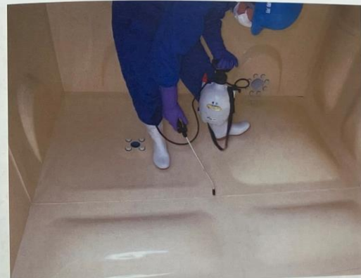
高架水槽No.1
