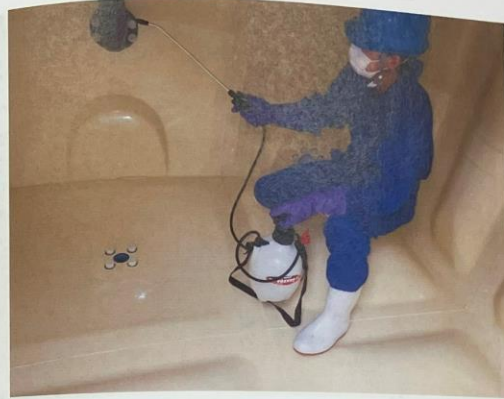
高架水槽No.1
