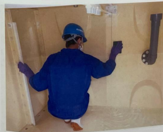
高架水槽No.2
